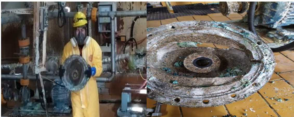
Рисунок 30 – Результаты двухмесячной работы адаптера, изготовленного из полимербетона
