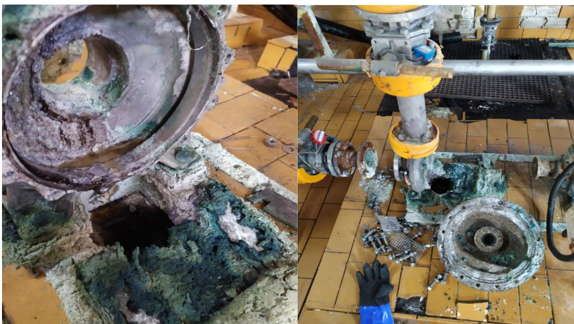
Рисунок 29 – Демонтаж адаптера после обнаружения утечки
